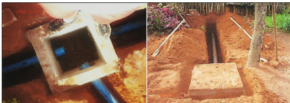
Figura 2 - Detalhe da construção de uma caixa de passagem, caixa pronta e coletor assentado na vala.
